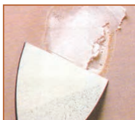
ب - لکه گیری و ترمیم ترک‌ها
